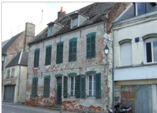
Exemples d'un bâti éprouvant des difficultés d'entretien.
