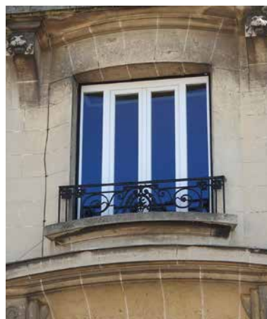
Exemple de fenêtre en rénovation, la surface vitrée est réduite d'au moins 1/3. Le blanc fait d'autant plus ressortir la menuiserie et donc accentue le problème de proportion.
