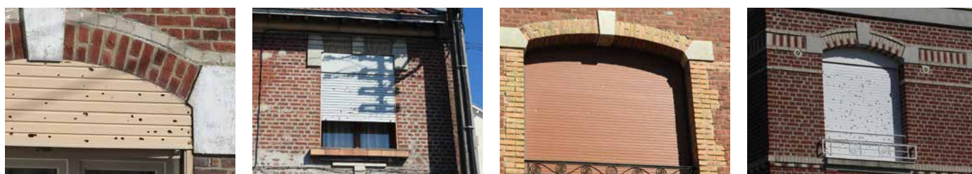
Volets en plastique : exemple de dégradations causées par la grêle.
