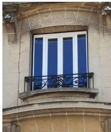
Exemple de fenêtre en rénovation, la surface vitrée est réduite d'au moins 1/3. Le blanc fait d'autant plus ressortir la menuiserie et donc accentue le problème de proportion.
